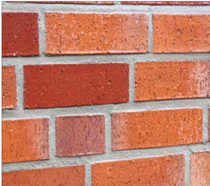
Abb.1, Unbehandelte Fassade. Wasser wird vom Baustoff aufgenommen.
